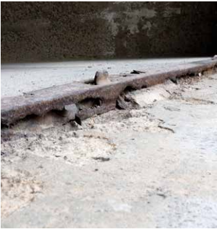
Höhenversatz an der Einfahrtsschiene mit Rampe angleichen
