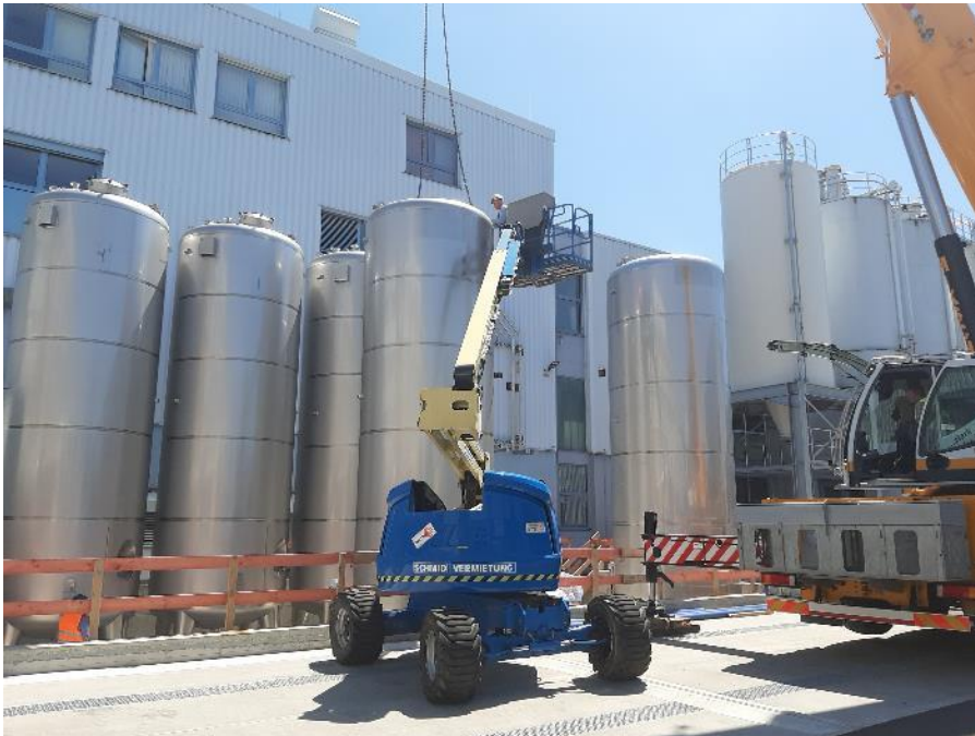
Teil der neuen Dispersionsanlage sind unter anderem sieben zusätzliche Rohstoff-Edelstahltanks (Bauphase im Sommer 2022). ( Link zum hochauflösenden Photo )
